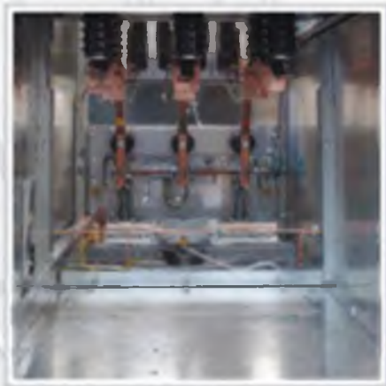
Отсек присоединений с открытой дверью
