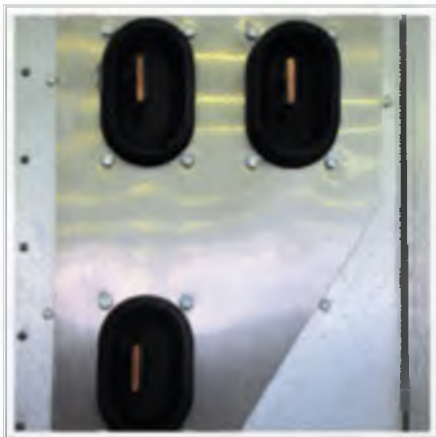
Отсек сборных шин с закрытыми клапанами сброса избыточного давления
