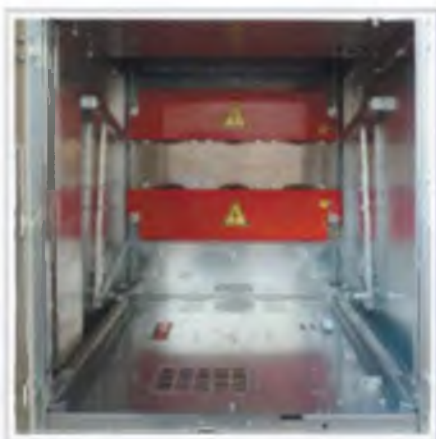
Отсек выдвижного элемента без КВЭ с открытой дверью
