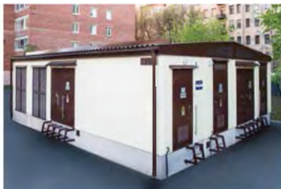
КТПМ 35 кВ №830 «Монетная» ОАО «Ленэнерго»
