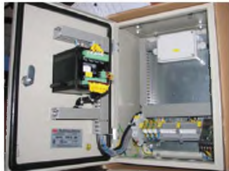
Рис.13. Блок контроля температуры производства производства GBE Sp.A.
