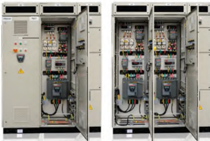
УПП 0,4 кВ 2x160 кВт
